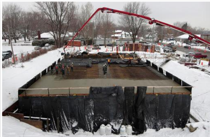
Congelamiento y deshielo (F)
