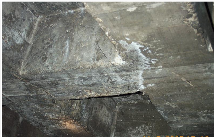
Carbonatación del hormigón
