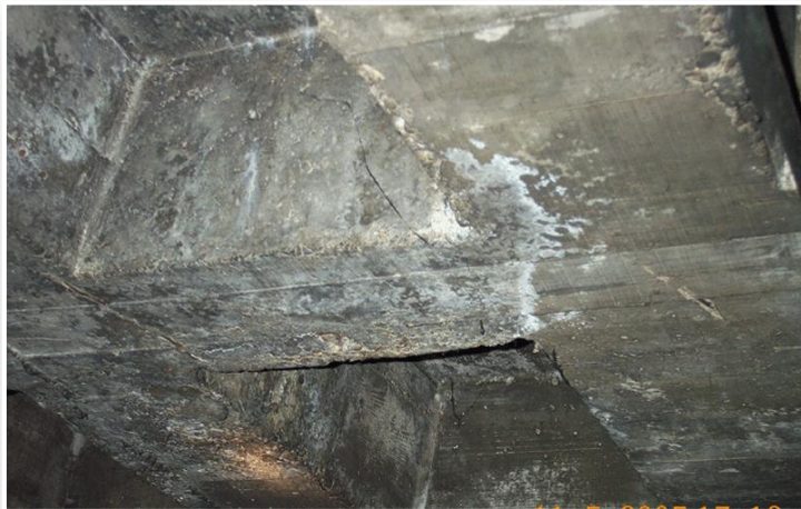
Carbonatación del hormigón
